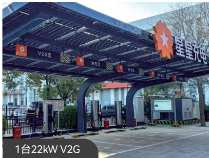
北京中企光储充放示范站 2024年11月上线
