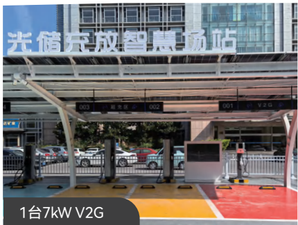
济南章丘公路局光储充示范站 2024年8月上线
