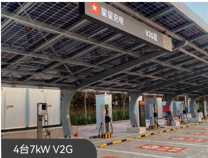
天津南站光储充放示范站 2024年10月上线
